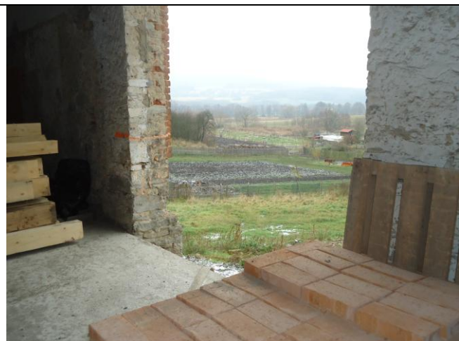
Zabezpečit pracovní otvory pevným zábradlím. Hrozí nebezpečí pádu z výšky a následnému úrazu. IHNED!
