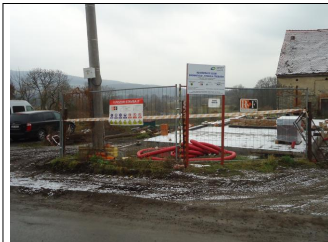
Oplocení staveniště pevným plotem dle požadavku plánu BOZP. Vstup označen výstražnými nápisy a piktogramy.
