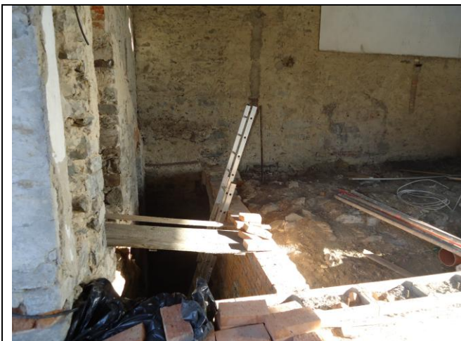
Žebřík zabezpečen proti skluzu s dostatečnou délkou nad výstupní plochu.
