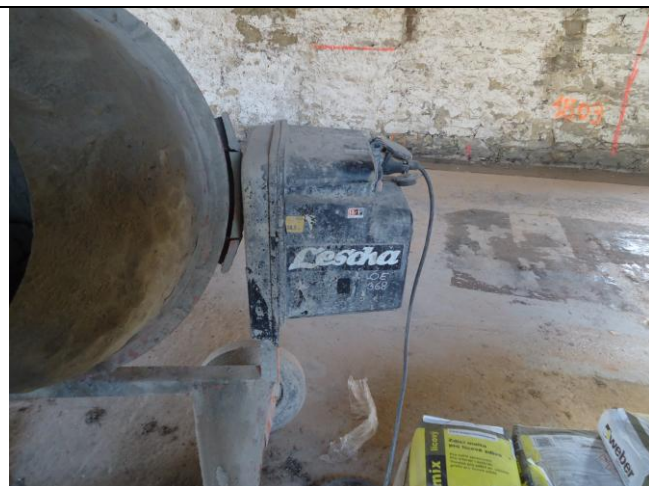
Veškeré strojní zařízení je označeno štítky
