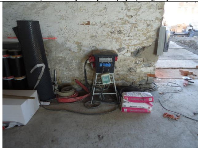
Elektro rozvaděč zajištěn, s platnou revizí, která je uložena u stavbyvedoucího. Bez připomínek
