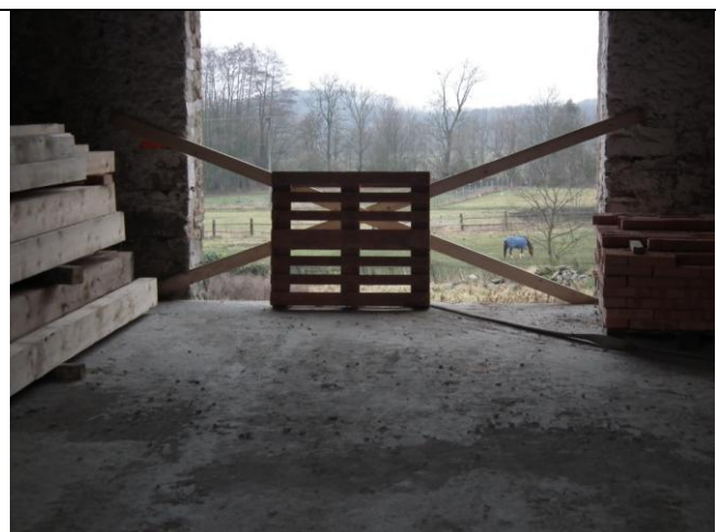
Zabezpečit pracovní otvory pevným zábradlím. Požadavek splněn.
