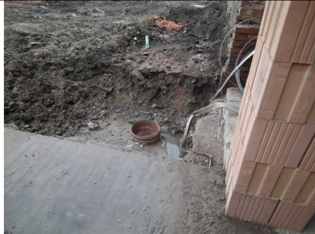
Je nutné zabezpečit výkopy dle plánu BOZP. Hrozí pád a úraz pracovníků.
