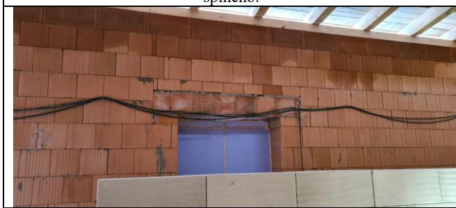
Opatření z předešlého KD11. Zavěšení kabelů dle požadavku splněno.
