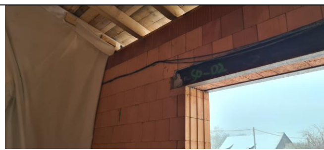
Opatření z předešlého KD11. Zavěšení kabelů dle požadavku splněno.
