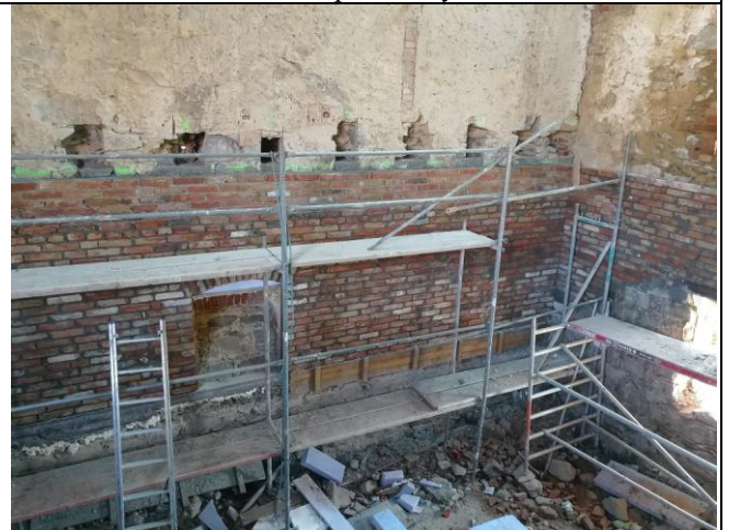
Místa, ze kterých by mohl hrozit pád z výšky (lešení) musí být zabezpečena oboustranným zábradlím. Doložit montážní a předávací protokol od lešení.
