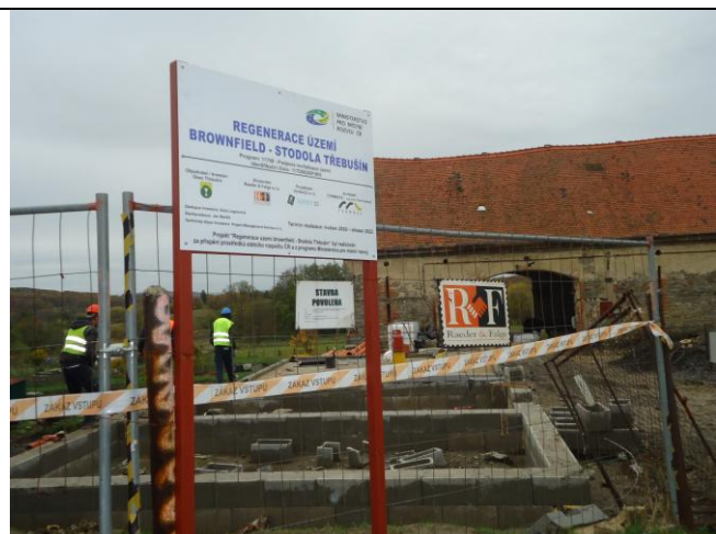
Označení stavby dle požadavku. V době KD všichni přítomní zaměstnanci byli vybaveni OOPP. Bez připomínek.
